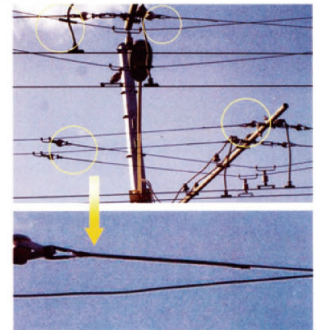
电气化铁路预绞式耐张金具应用实例 (2)
